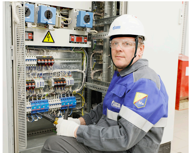
Электромонтер по ремонту и обслуживанию электрооборудования газоконденсатного промысла № 1А Александр Карташов
