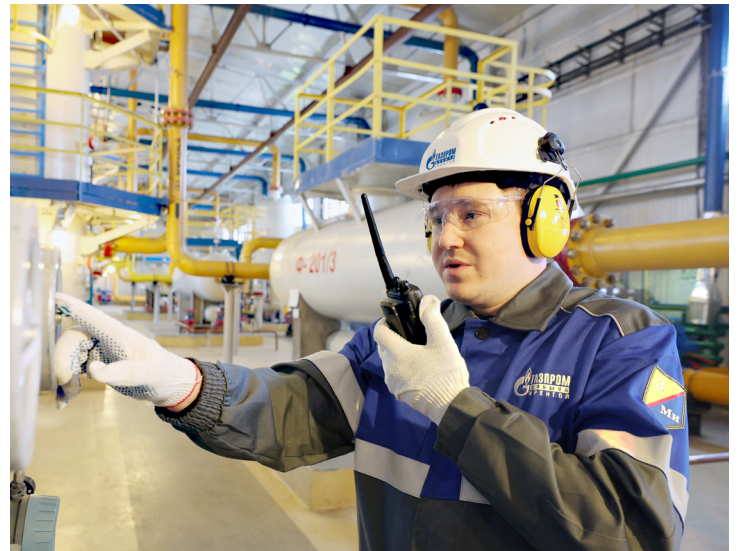
Оператор по добыче нефти и газа газового промысла № 4 Ильнар Тухбатуллин
