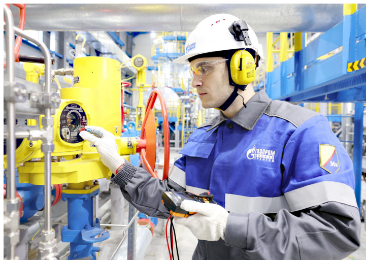
Слесарь по КИП и А ГКП-21 Артем Ильницкий проводит ревизию интеллектуального электропривода
