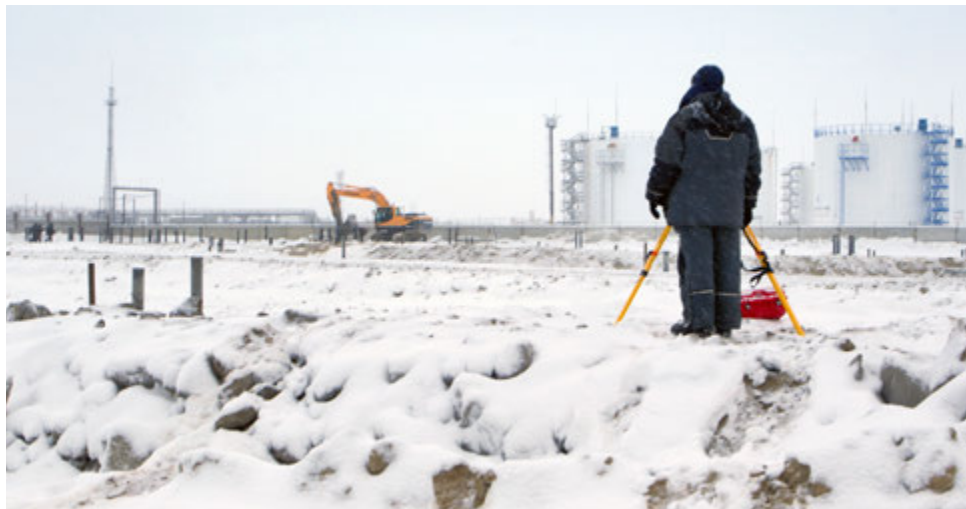
Строители только приступили к реализации проекта. Новые резервуары с метанолом будут расположены рядом с уже имеющимися
