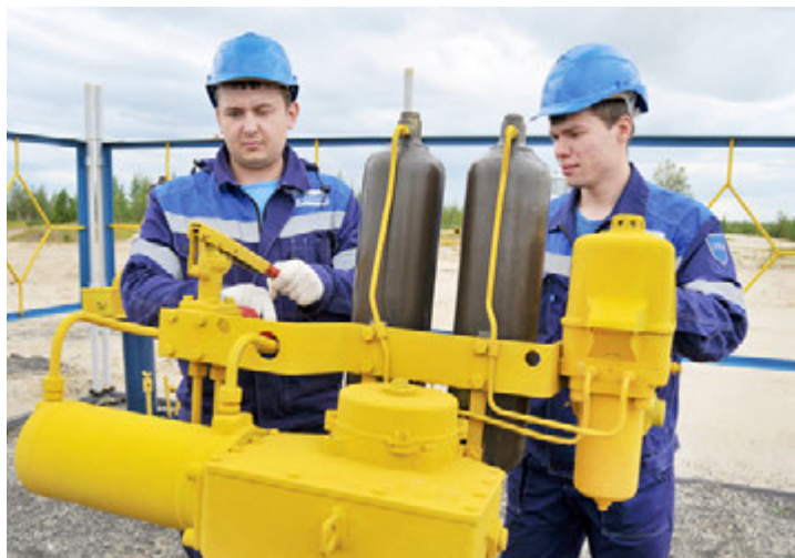
Слесарь по ремонту технологических установок Сергей Теребейчик и трубопроводчик линейный Марат Маслов — работники линейно-эксплуатационной службы № 1
