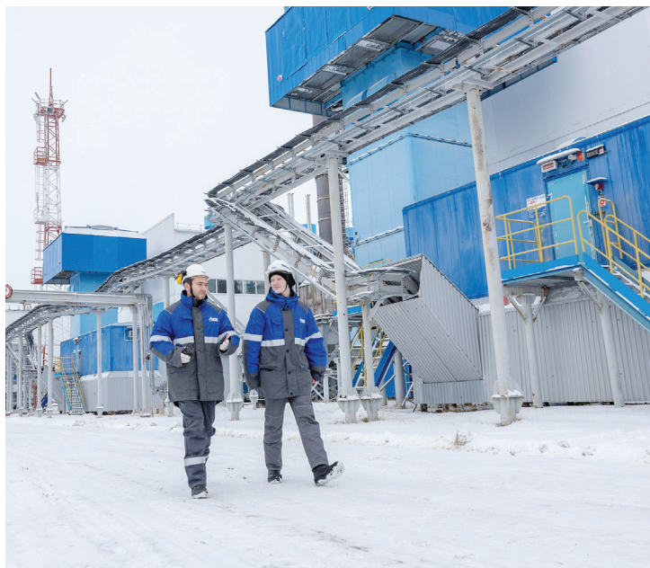
Во время обхода производственный персонал компрессорной станции ведет осмотр основного и вспомогательного оборудования
