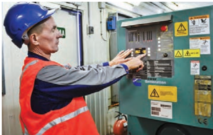
Электромонтер Валерий Большаков проверяет на панели управления параметры работы дизельного генератора «Звезда», обеспечивающего энергоснабжение комплекса административных зданий Общества в случаях аварийного отключения городских систем
