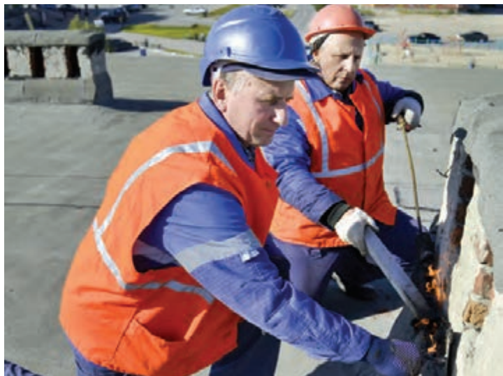
Рабочие по комплексному обслуживанию зданий и сооружений Виталий Пишинозуб и Михаил Леднев восстанавливают кровлю научной библиотеки Инженерно-технического центра
