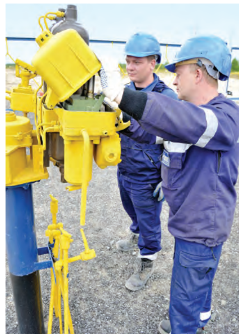
Дмитрий Белик, линейный трубопроводчик, и Леонид Серегин, слесарь по ремонту ТУ, производят техническое обслуживание шарового крана (Ди 1400 мм)
