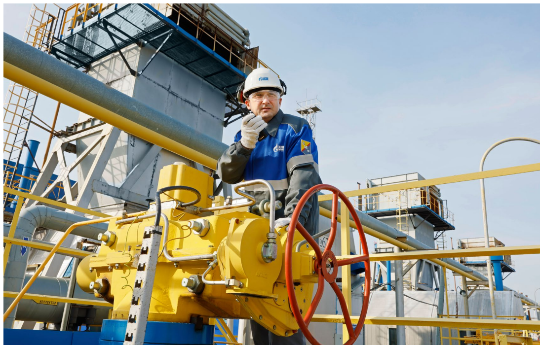
Ведущий инженер по ДКС Игорь Сенин проверяет работоспособность шаровых кранов газоперекачивающего агрегата дожимной компрессорной станции ГП-6
