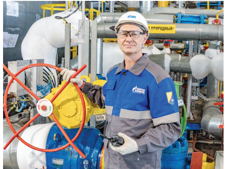
Ведущий инженер-энергетик ГПП-22 Газопромислового управления по разработке ачимовских отложений Сергей Алексеев
