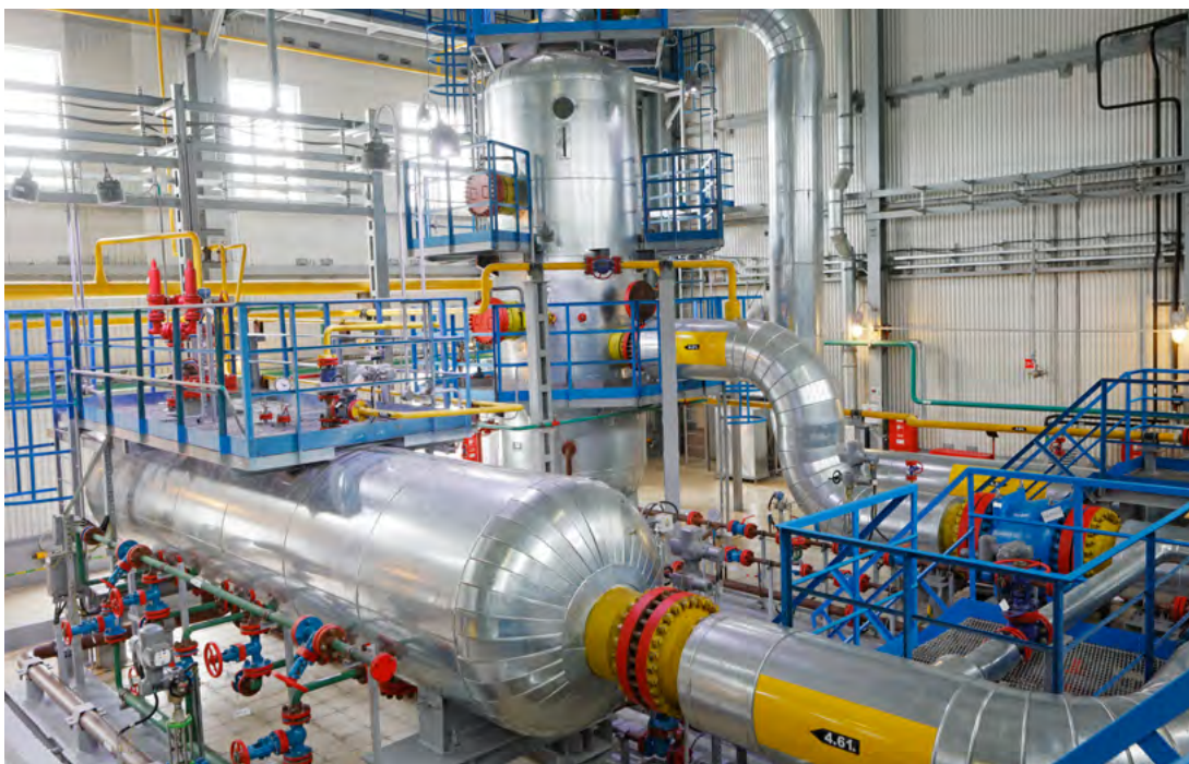
В цехе очистки газа ДКС-1АВ
