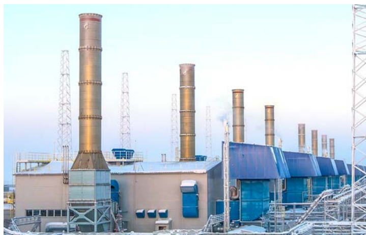
Общество «Газпром добыча Уренгой». Новые газоперекачивающие агрегаты на дожимной компрессорной станции 1АВ практически полностью состоят из отечественных деталей
