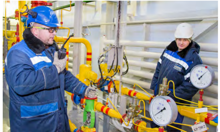
Установка подготовки топливного и пускового газа. За работой — машинисты технологических компрессоров второго нефтепромысла НГДУ Максим Ивченко и Евгений Васильков
