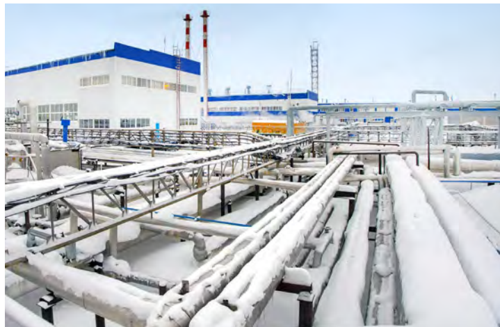
Компрессорная станция № 2 НГДУ
