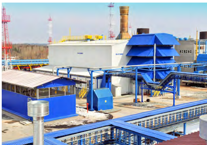
Газоперекачивающий агрегат «Ладога» на компрессорной станции «Вавожская»
